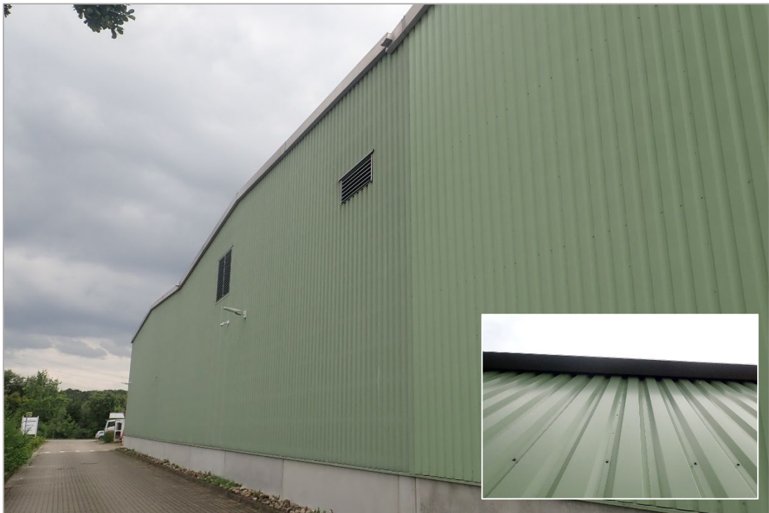
Abb. 8: Zu erweiternde Produktionshalle mit Hohlräumen zwischen Metallverkleidung und Fassade
